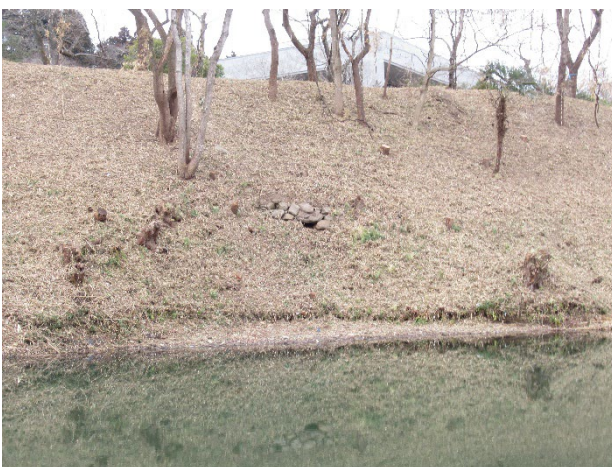
イ 土塁法面の排水施設（長沼側）
