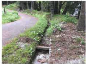
図 7-32 目詰まりしている側溝
