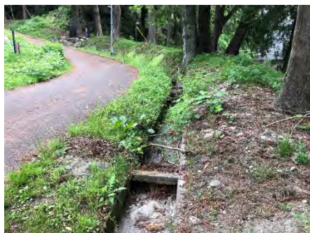
図 7-34 目詰まりしている側溝
