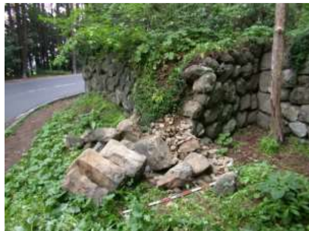
図 3-98 平成 15 年（2003）地震による中門南石垣 の被災状況
