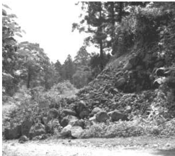
図 3-96 昭和 39 年（1964）新潟地震による 清水門石垣の被災状況
