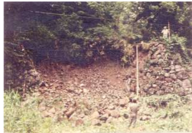
図 3-97 昭和 53 年（1978）宮城県沖地震による 清水門石垣の被災状況
