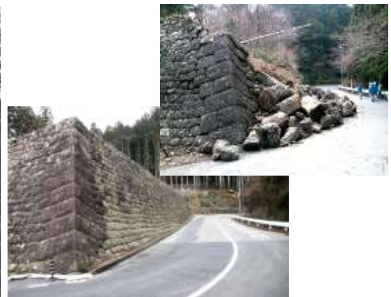
図 2-20 東日本大震災による本丸北西石垣の被災と修復状況
