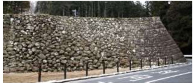
図 3-95 本丸北西石垣 D 面 複数の修復履歴が確認される
