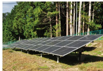
本社敷地内の太陽光パネル
