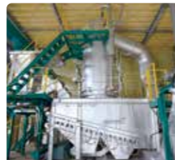
木質チップを燃料としたバイオマスボイラ
