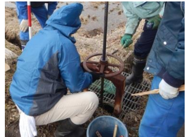
交付金を活用した取組み・水路 ゲートの点検 (太白区秋保町)
