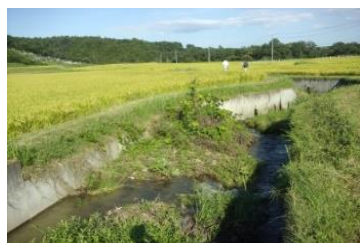
水路土砂堆積状況
