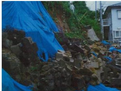
宮城野区東仙台：人家裏の法面崩壊
