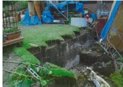
宮城野区岩切入山：法面崩壊による人家被害
