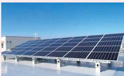
▲学校屋上の太陽光発電パネル
